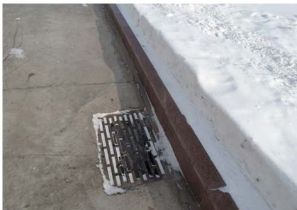
插图 1 厂区道路外侧布设雨水口
